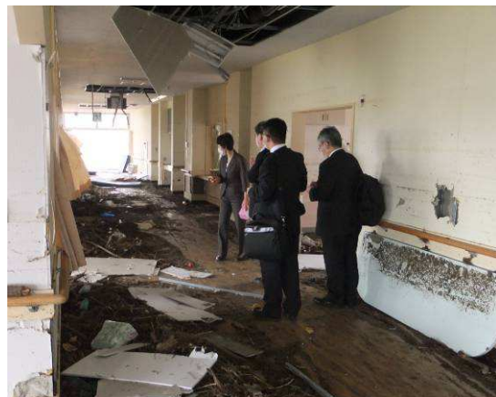
1階の天井付近まで津波が押し寄せた
