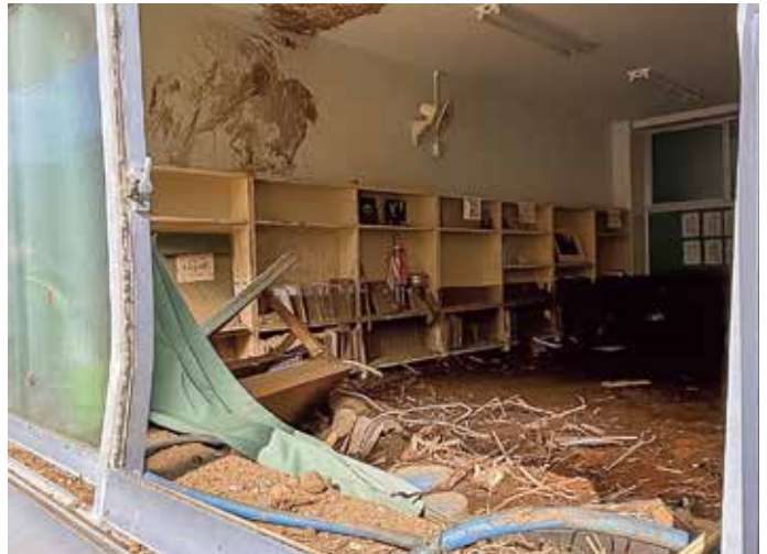
避難所内に流入した土石流
