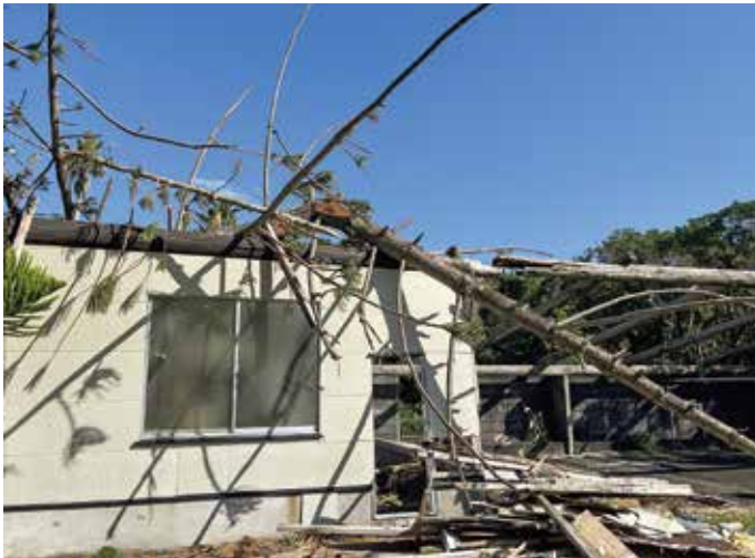
暴風雨による建物被害
